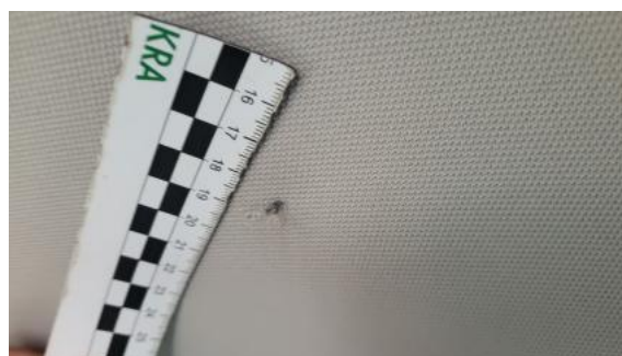
Fot. 48 Podsufitka - Pęknięcie/rozerwanie 1
