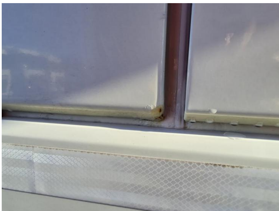
Fot. 38. ściana boczna P
